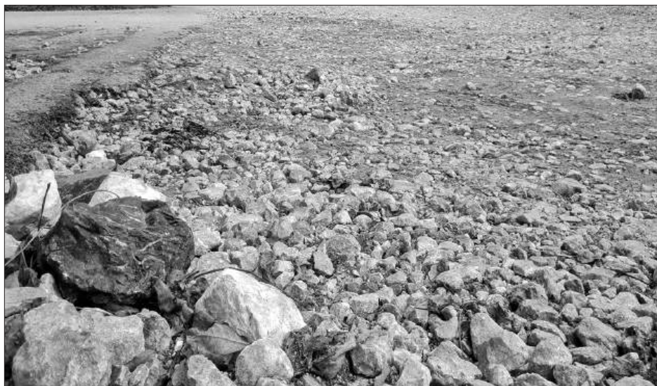
Mặt đường Hương Lý bong tróc, không đảm bảo an toàn giao thông.
