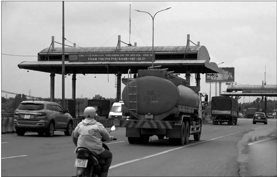
Trạm thu phí đã ngưng hoạt động có dấu hiệu xuống cấp nhưng chưa được tháo dỡ, gây cản trở và mất an toàn giao thông.
